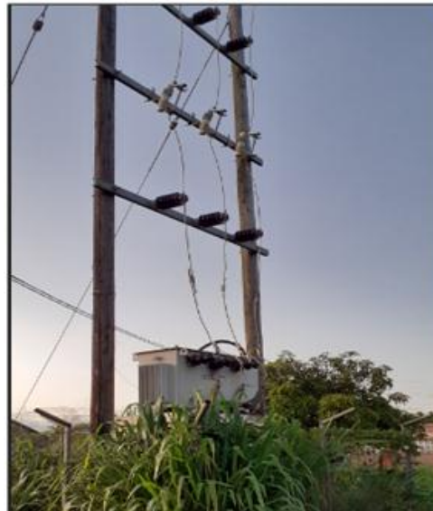
Figura 14 - Poste de Transformação.
