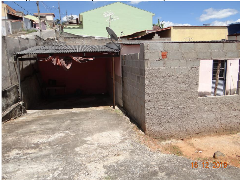
Figura 12 – Identificação in loco da construção em Área Verde
