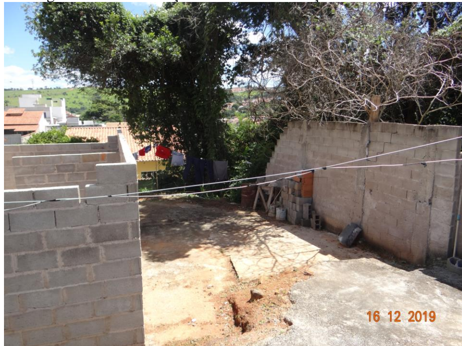
Figura 13 – Identificação in loco da construção em Área Verde
