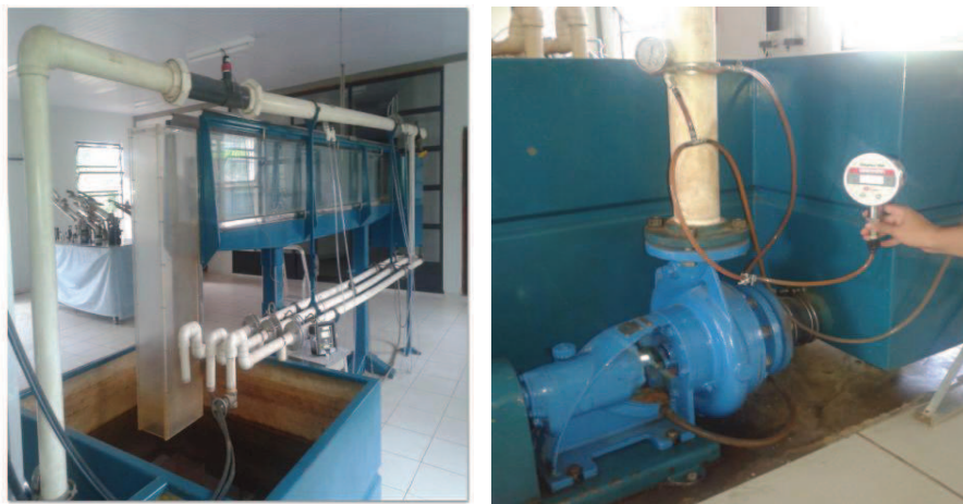
Figura 8 Tubulação de recalque da bomba ETA 80-20
