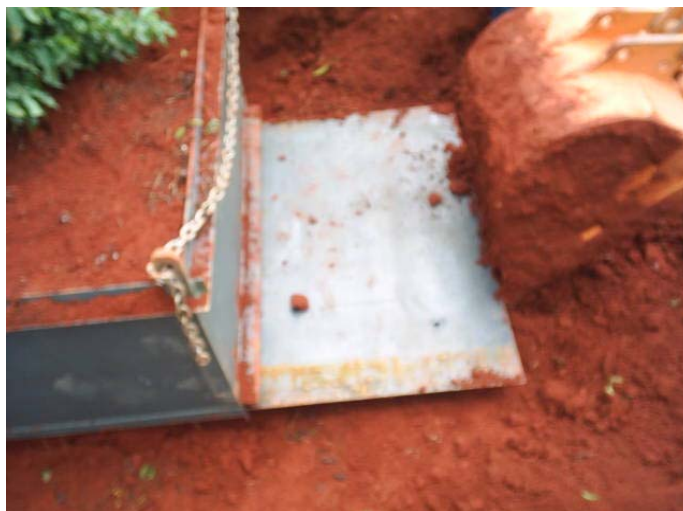
Figura 4 Detalhe de inserção da chapa metálica do fundo do lisímetro por meio do “braço” da retroescavadeira UFLA, Lavras-MG, 2010
