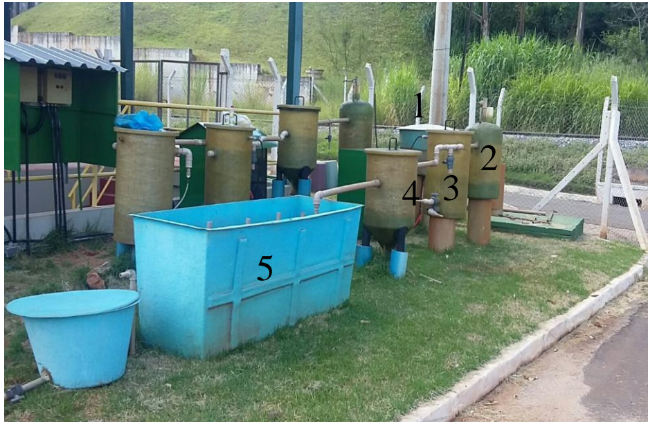
Figura 2. Linha de tratamento do esgoto composta por reator TEq (1), RAFA (2), FBAS (3), DS (4) e SAC (5), localizada nas dependências da ETE-UFLA, utilizados experimentalmente no tratamento do esgoto sanitário da UFLA.
