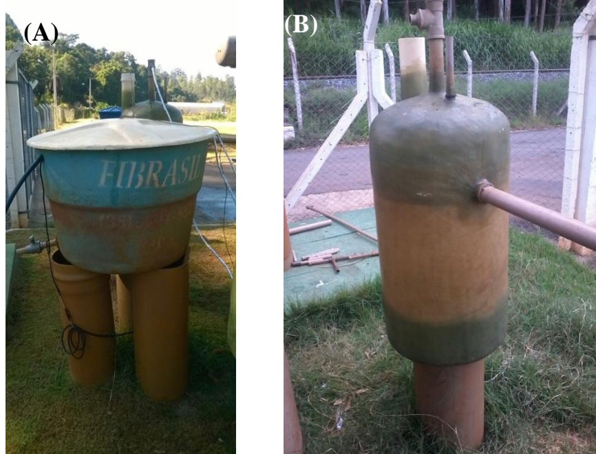
Figura 3. Visualização externa do tanque de equalização (A) e do reator anaeróbio de manta de lodo e fluxo ascendente (B), utilizados experimentalmente no tratamento do esgoto sanitário da UFLA.
