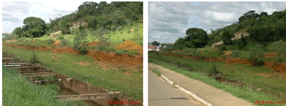
Figura 92 – Estrutura de controle de cheia localizado no Ponto A7 do ribeirão Araras.
