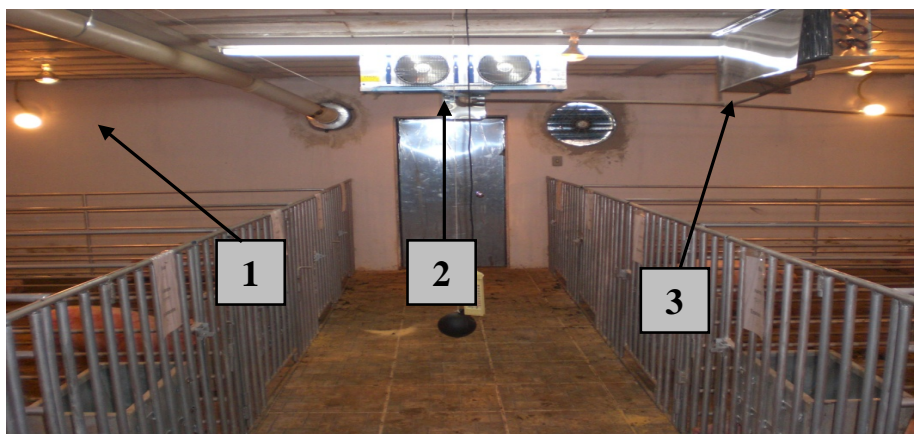
Figura 2 Sala climatizada ilustrando aquecedores (1); refrigerador (2); e o desumidificador (3)
