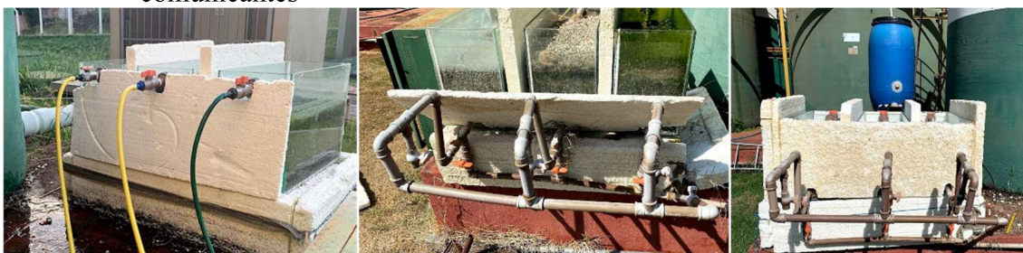
Figura 3 – Tubulações de entrada do efluente e saída fundamentada na teoria dos vasos comunicantes
