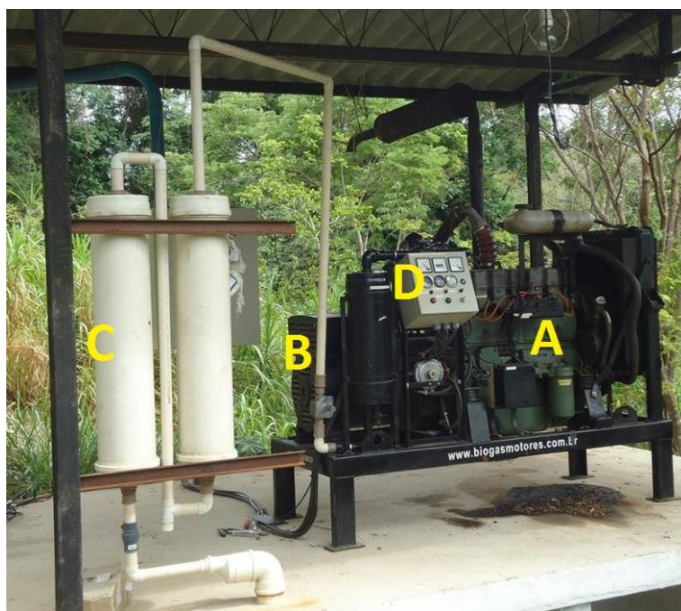
Figura 2. Conjunto motor gerador de eletricidade. Observação: A = motor Mercedes Benz; B = gerador de eletricidade; C = sistema de purificação do biogás; D = painel de controle.
