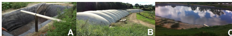
FIGURA 1. Sistema de tratamento de resíduos da suinocultura: A = tanque de equalização; B = biodigestores modelo canadense; C = lagoa de estabilização. System of treatment of swine production wastes: A = equalization tank; B = tubular anaerobic biodigester; C = stabilization pond.
