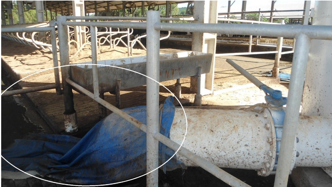
Figura 35 - Lona de direcionamento do jato do flushing .
