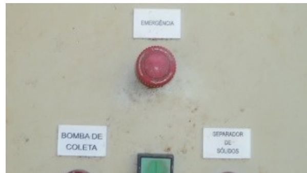
Figura 3 - Painel para controle da máquina separadora de sólidos, motobomba e emergência.
