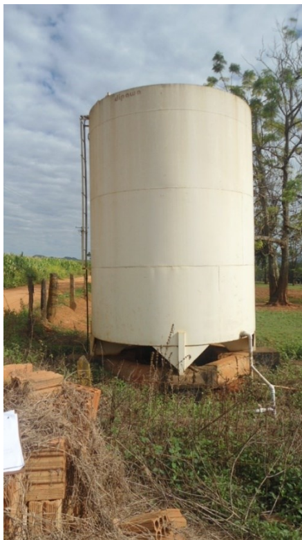
Figura 43 - Caixa de água mestre.
