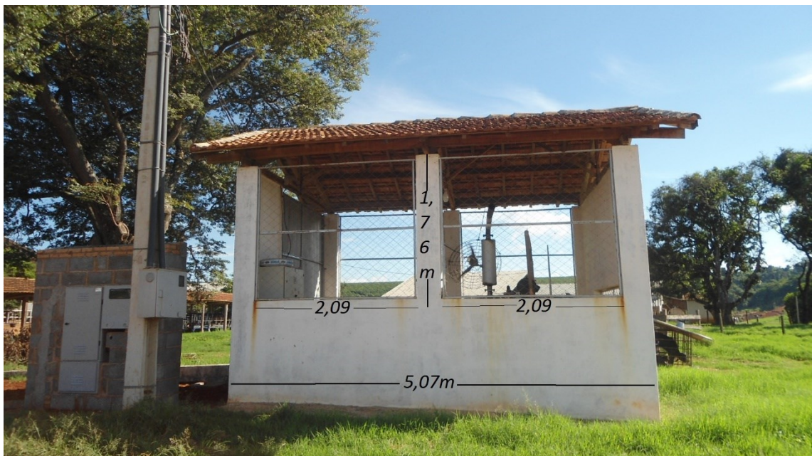
Figura 9 - Lateral do abrigo do grupo gerador.
