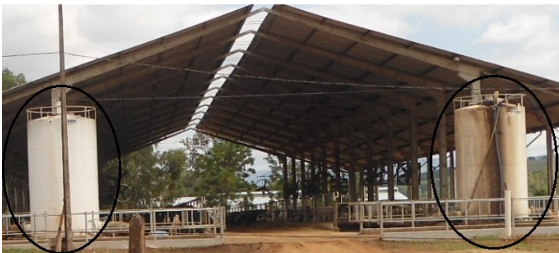
Figura 34 - Reservatório de biofertilizante para realizar o flushing , galpão 2.
